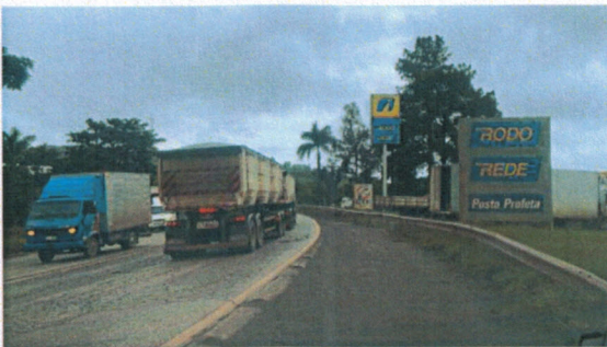
Foto 67 (Km 611): Pavimento degradado.
