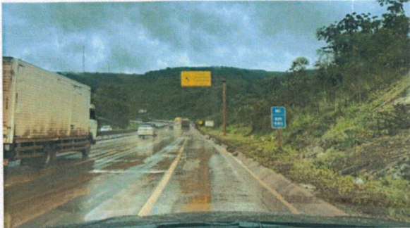
Foto 33 (Km 590): Pavimento degradado.
