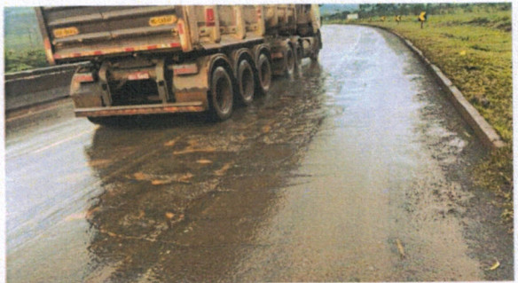
Foto 36 (Km 591): Pavimento degradado.
