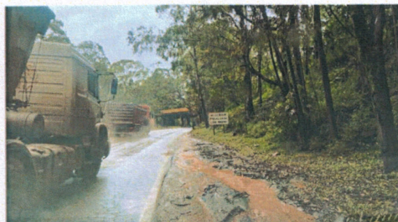
Foto 47 (Km 596): Falta de drenagem.
