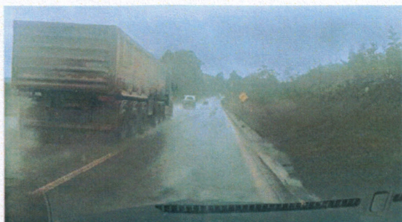
Foto 3 (Km 566): Canaleta obstruída.
