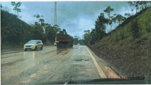
Foto 43 (Km 595): Pavimento degradado.
