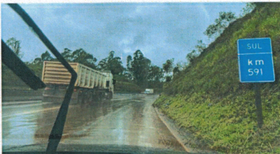
Foto 35 (Km 591): Pavimento degradado.
