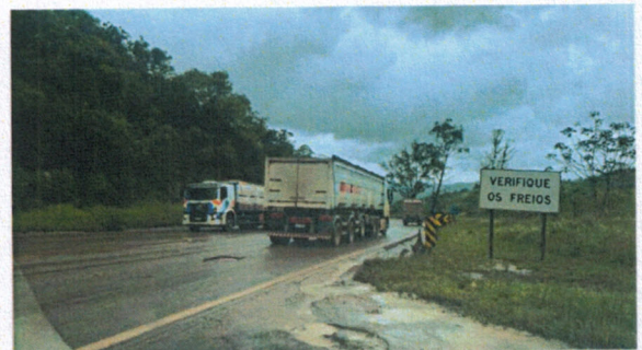
Foto 30 (Km 586): Pavimento degradado.
