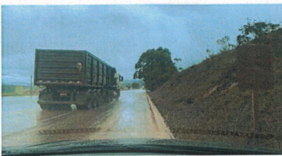
Foto 6 (Km 569): Sinalização ilegível.
