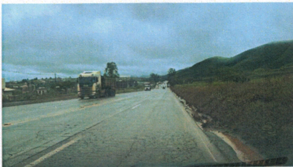
Foto 8 (Km 570): Canaleta obstruída.
