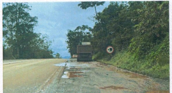
Foto 22 (Km 577): Acostamento com pavimento degradado.
