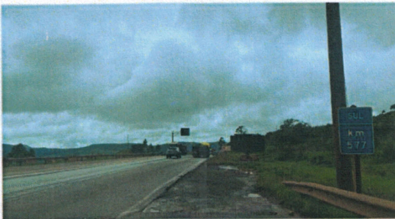
Foto 19 (Km 577): Degrau para acostamento.
