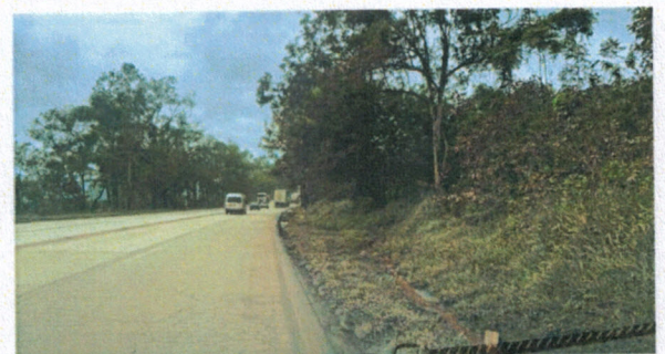
Foto 24 (Km 581): Falta de drenagem.
