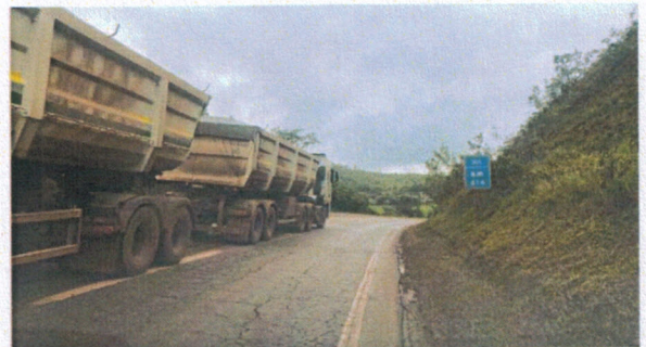
Foto 70 (Km 616): Pavimento degradado.
