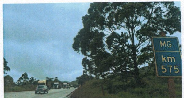
Foto 14 (Km 575): Falta de acostamento.
