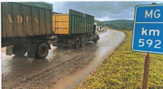
Foto 37 (Km 592): Pavimento degradado.
