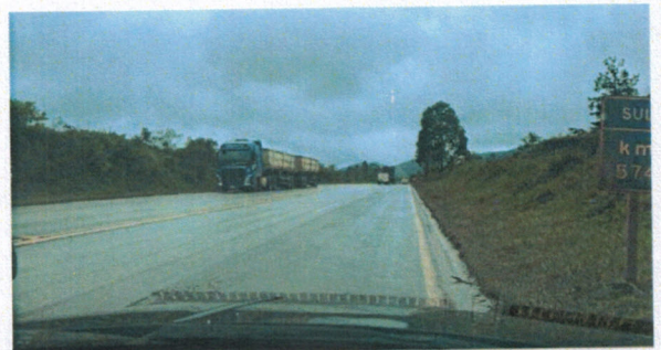
Foto 12 (Km 574): Falta de acostamento.
