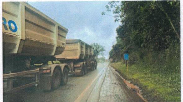
Foto 58 (Km 605): Pavimento degradado.
