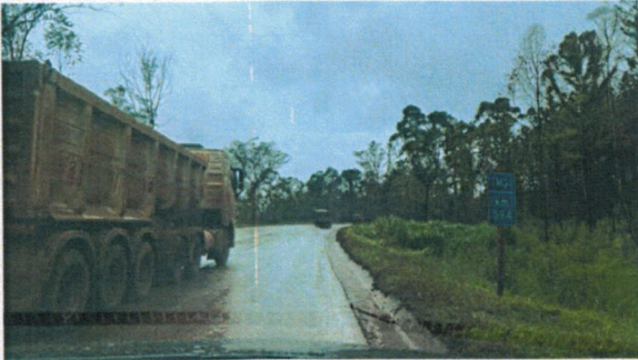
Foto 41 (Km 594): Falta de Acostamento.
