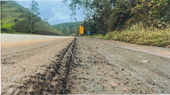
Foto 25 (Km 581): Acostamento em degrau.
