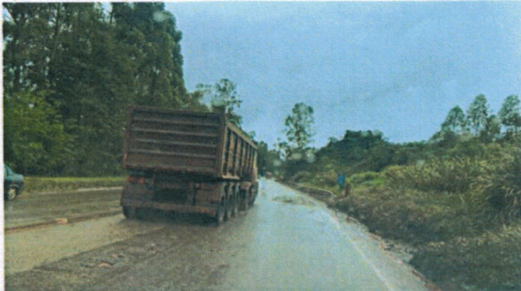
Foto 49 (Km 598): Falta de acostamento.
