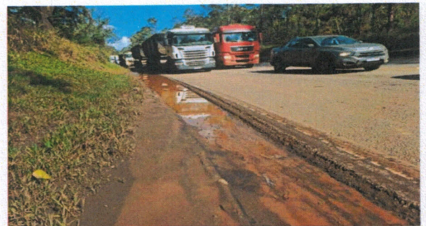
Foto 46 (Km 596): Canaleta obstruída.
